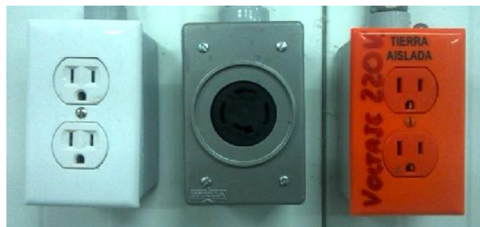
Figura 3. Conexiones bifásicas que suministran voltajes de 110 (color blanco) y 220 (color rojo) y trifásicos (conexiones color gris).
